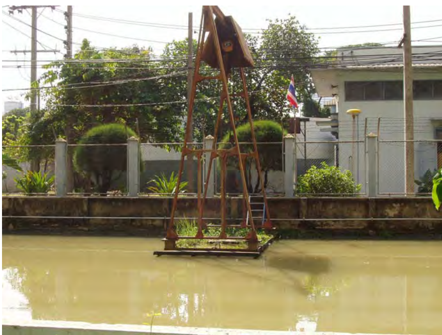
รูปที่ 3.13 บริเวณปล่อยน้ำเข้าบ่อพักน้ำภายในโรงกรองน้ำสามเสน 2
