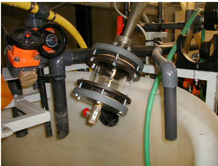
รูปที่ 3.3 การติดตั้งกริตพอทที่ทางน้ำออกด้านล่าง
