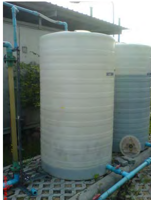
รูปที่ 3.3 ถังผสมน้ำเสีย และ ถังเก็บตะกอน
