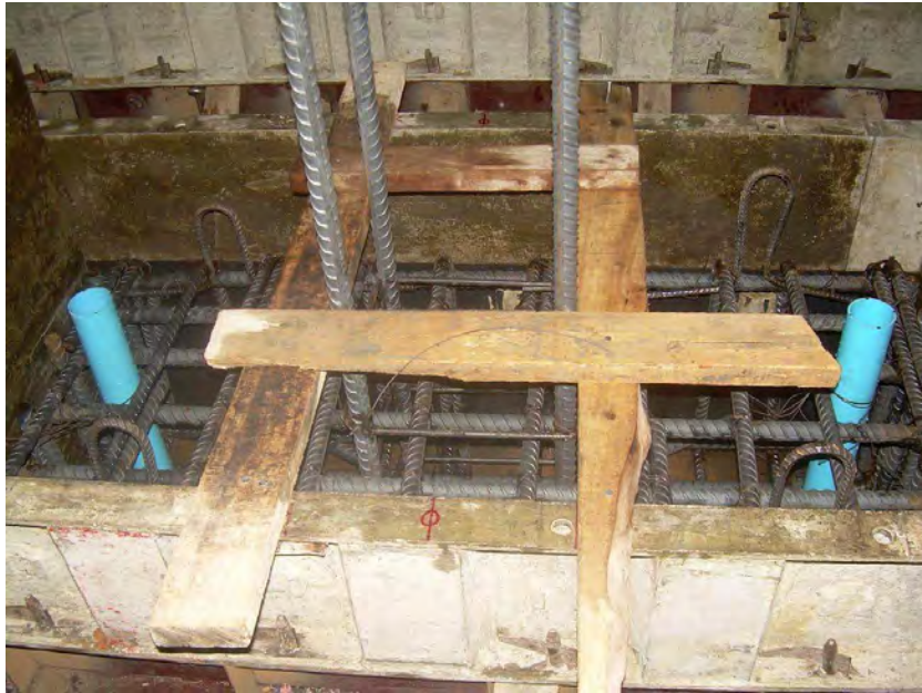
รูปที่ 4.9 การวางตำแหน่งของเหล็กเสริมตามยาวและท่อน้ำพีวีซี
