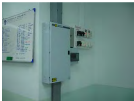
รูปที่ 5-48 สวิตช์หลัก (master switch)
