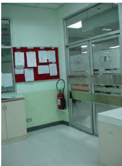
รูปที่ 6-31 ถังดับเพลิงมือถือ ติดตั้งที่ความสูง 0.60 เมตร
