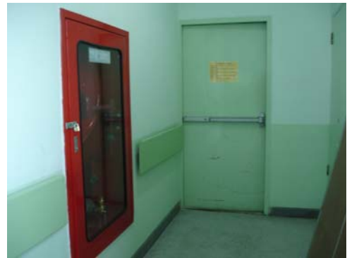
รูปที่ 5-52 ตู้เก็บสายฉีดน้ำดับเพลิง
