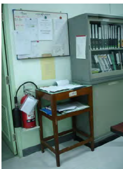
รูปที่ 5-50 ถังดับเพลิงมือถือ
