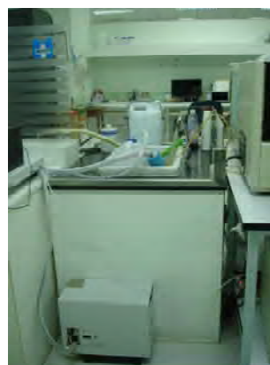
รูปที่ 6-30 อ่างน้ำที่ถูกใช้เป็นที่วางถัง สำหรับทิ้งสารเคมีซึ่งมีสายไฟพาดผ่าน
