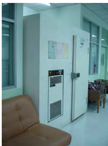
รูปที่ 5-42 ห้องเย็น
