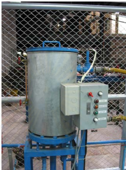
รูปที่ 5-12 Cooling Water Tank
