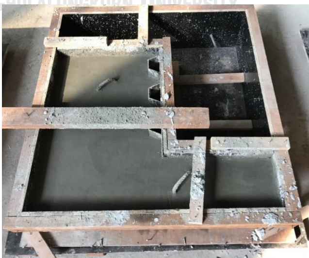
รูปที่ 3. 15 เทคอนกรีตในแบบหล่อครั้งที่ 1
