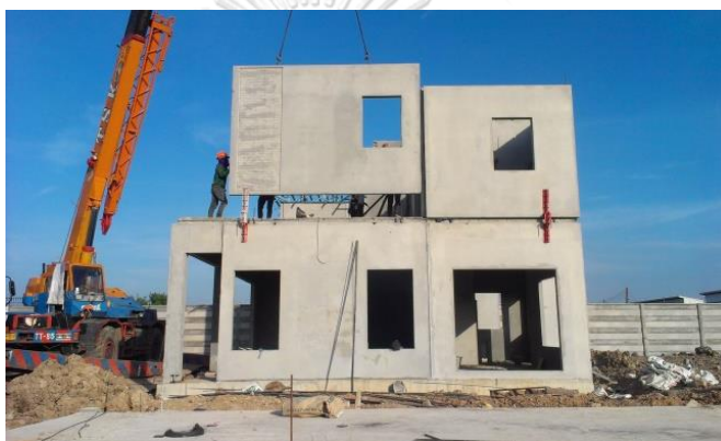
ภาพที่ 84 งานติดตั้งชิ้นส่วนผนังคอนกรีตสำเร็จรูป ชั้นบน บริษัท พกษา โฮลดิ้ง จำกัด (มหาชน)
