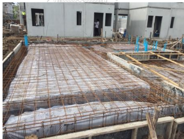
ภาพที่ 26 โครงสร้างพื้นคอนกรีตหล่อกับที่ ชั้นล่าง บริษัท พฤกษา โฮลดิ้ง จำกัด (มหาชน)
