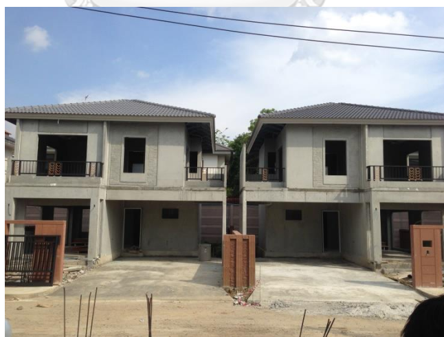
ภาพที่ 50 งานเทพื้นคอนกรีตหน้าบ้าน บริษัท พกษา โฮลดิ้ง จำกัด (มหาชน)
