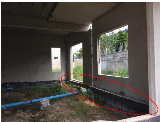
ภาพที่ 27 หูช้างบริเวณใต้ฐานผนัง ชั้นล่าง บริษัท โลฟ แอนด์ ลีฟวิ่ง จำกัด
