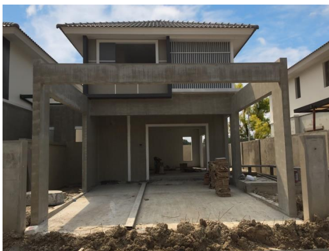
ภาพที่ 49 งานเทพื้นคอนกรีตหน้าบ้าน บริษัท โลฟ แอนด์ สลิวิ่ง จำกัด
