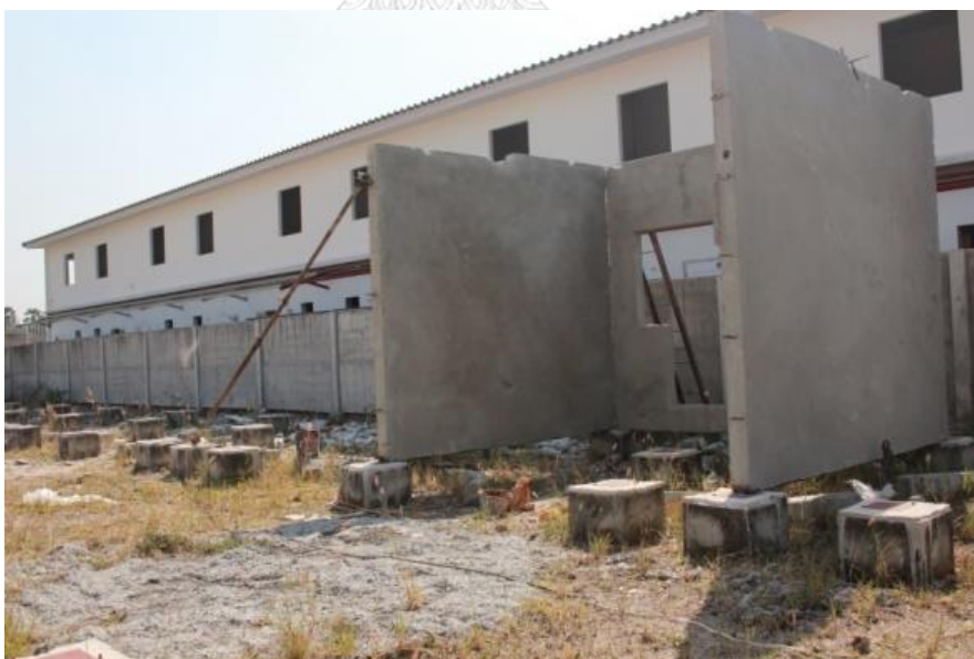
ภาพที่ 86 งานที่ 1 ติดตั้งผนัง ชั้นล่าง บริษัท ไลฟ์ แอนด์ ลีฟวิ่ง จำกัด
