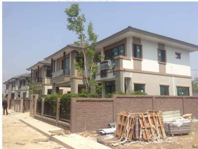
ภาพที่ 73 งานเทพื้นคอนกรีตและปูตบหน้าบ้าน บริษัท พกษา โฮลดิ้ง จำกัด (มหาชน)
