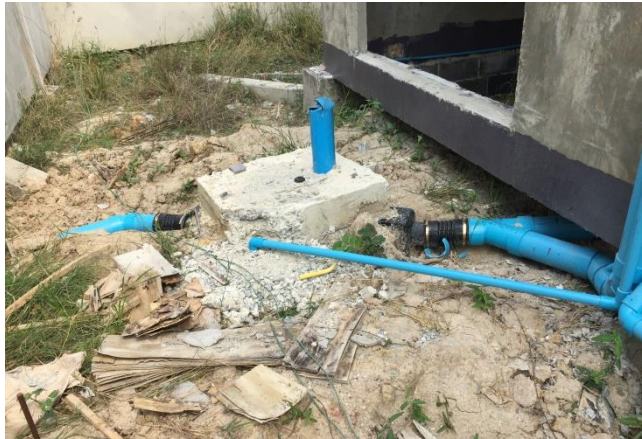
ภาพที่ 37 การเดินท่องานระบบเข้าถึงบำบัดน้ำเสีย บริษัท โลฟ แอนด์ สีฟวี่ จำกัด
