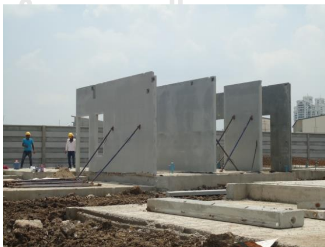
ภาพที่ 91 งานที่ 1 ติดตั้งผนัง ชั้นล่าง บริษัท พุกษา โฮลดิ้ง จำกัด (มหาชน)
