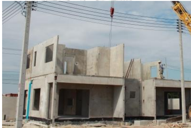
ภาพที่ 88 งานที่ 3 ติดตั้งผนัง ชั้นบน บริษัท โลฟ แอนด์ สีฟวี่ จำกัด
