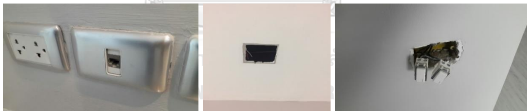
รูปที่ 21 ตัวอย่างข้อบกพร่องที่มีข้อขัดแย้งที่เกิดขึ้นในพื้นที่เชิงซ้อน (ซ้าย) เอาท์เล็ตชำรุด (กลาง) ไฟดาว์นไลท์หาย (ขวา) ไม่ได้ติดตั้งสวิตช์
