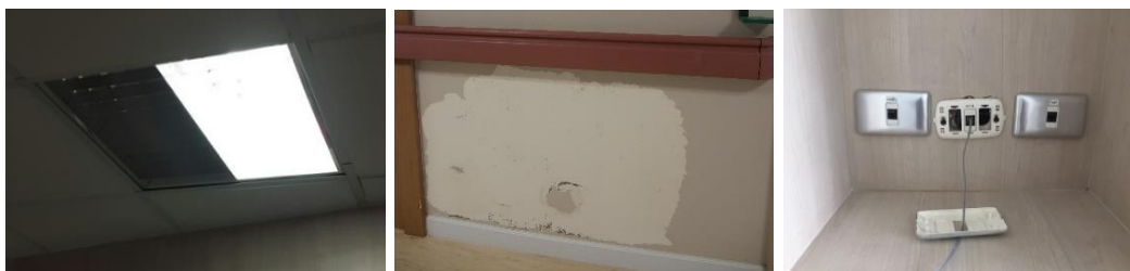
รูปที่ 13 ตัวอย่างของชำรุดเสียหายในโครงการ (ซ้าย) ไฟไม่ติด (กลาง) ผนังถลอก (ขวา) เอาท์เล็ตไม่เรียบร้อย
