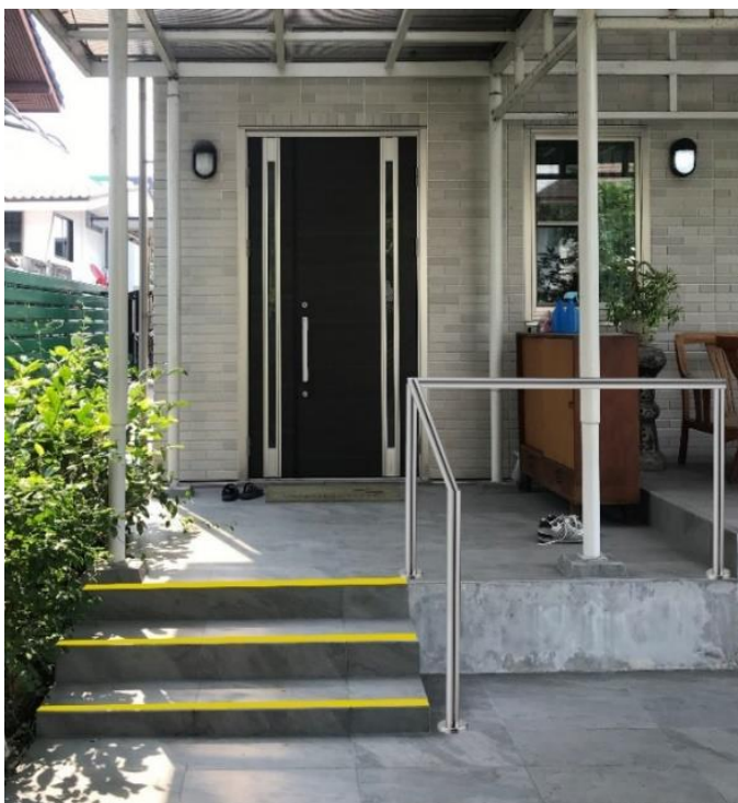
ภาพที่ 121 แสดงการติดราวกันตกและแถบเส้นสะท้อนแสง
