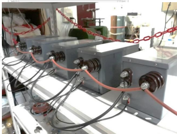
หม้อแปลงนีออนไลท์ (Neon sign transformer)
