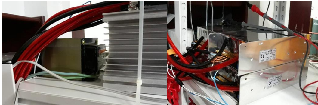
หม้อแปลงขึ้น (Step-up Transformer)
