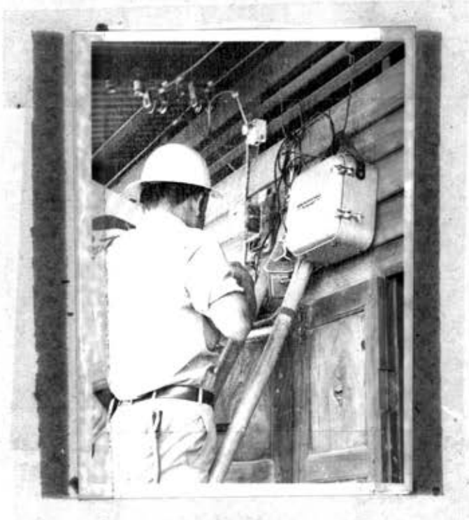
รูปที่ 3.3.5 การติดตั้งเครื่องมือเพื่อทดลองที่อาคารของศูนย์ไฟฟ้า
