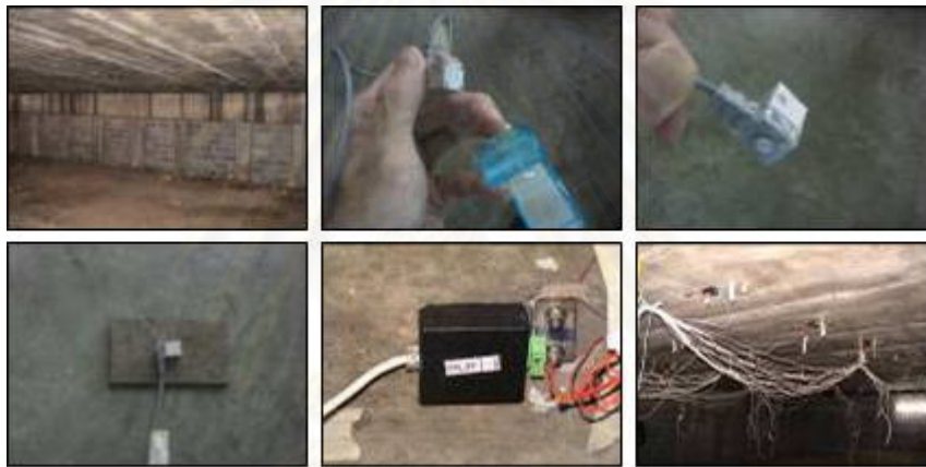
รูปที่ 6.4 ขั้นตอนการติดตั้งอุปกรณ์วัดความเร่งในสะพานเข้ากับสะพาน
