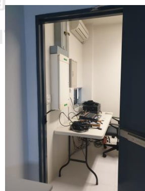
(ห้องควบคุม)
