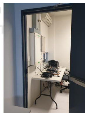
(ห้องควบคุม)
