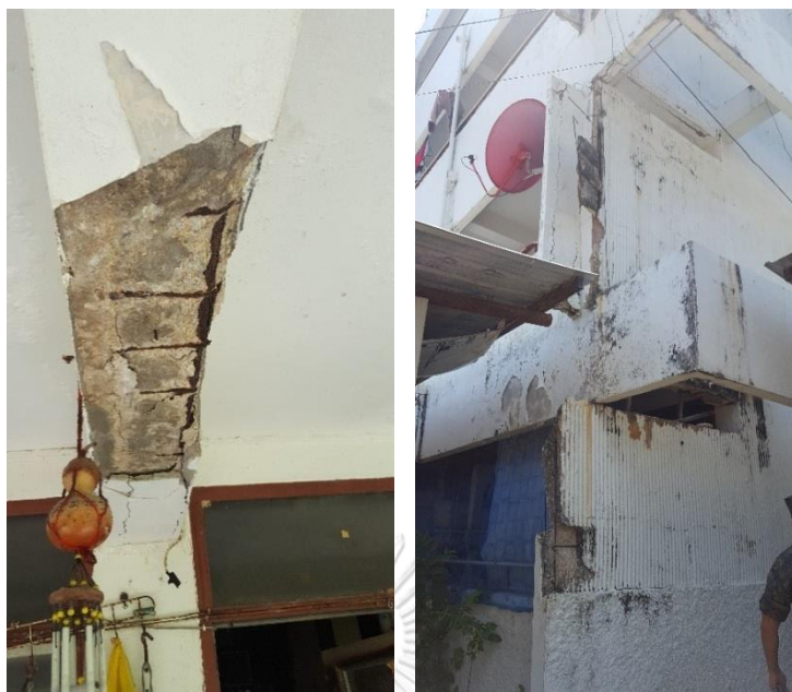
รูป 2-2 โครงสร้างคอนกรีตเสริมเหล็กที่เสื่อมสภาพในพื้นที่ใกล้ทะเล
