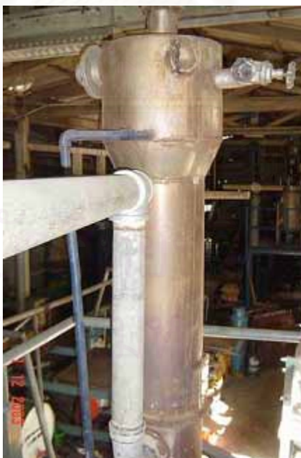
รูปที่ 3.4 หอดูดซึม (Absorption column)
