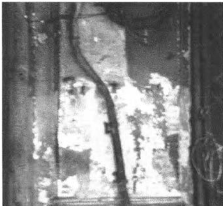
ภาพที่ 162 ปัญหาทางสถาปัตยกรรมที่เกิดจากความชื้นที่ทำให้ผนังปูนฉาบเปื้อน เสื่อมสภาพ
