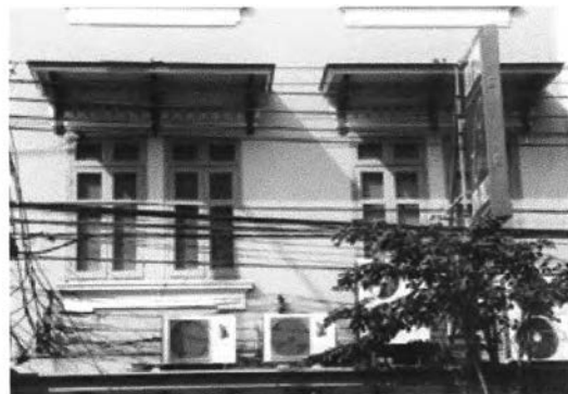
ภาพที่ 109 ลักษณะหน้าต่างด้านหน้าชั้นสองของตึกแถวริมถนนเจริญกรุง ซอย 34 ตรอกวัดม่วงแค
