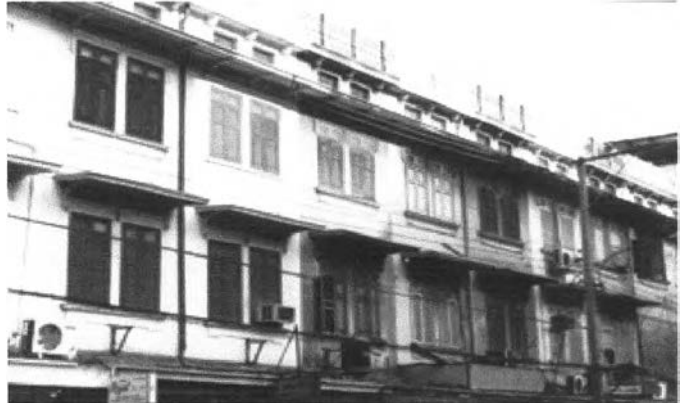
ภาพที่ 160 ปัญหาทางสถาปัตยกรรมที่เกิดจากการปรับปรุงเปลี่ยนแปลงองค์ประกอบของตึกแถว และการเพิ่มส่วนประกอบต่างๆ เช่น ป้ายโฆษณา กันสาดผ้าใบ ระบบปรับอากาศ สายไฟฟ้า เป็นต้น
