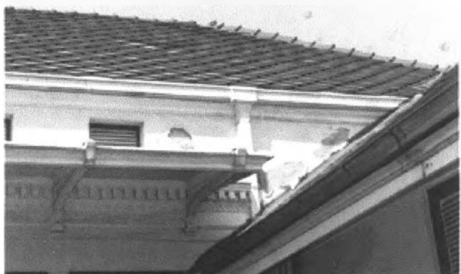
ภาพที่ 62 ผนังปูนฉาบหลุดร่อนและเสื่อมสภาพ เนื่องจากกาลเวลาและความเก่าของตึกแถว
