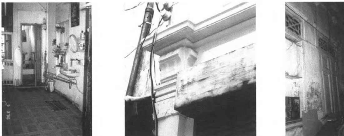
ภาพที่ 93 ปัญหาทางสถาปัตยกรรม เช่น การเพิ่มส่วนห้องน้ำ การเปลี่ยนประตูเดิมเป็นประตูเหล็กม้วน การปิดหน้าต่างเดิม เป็นต้น ซึ่งทำให้ลักษณะดั้งเดิมของอาคารถูกทำลาย
