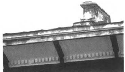
ภาพที่ 156 ลักษณะผนังกันไฟบนหลังคาของชุดตึกแถว 2 ชั้น ริมถนนเจริญกรุง ซอย 43
