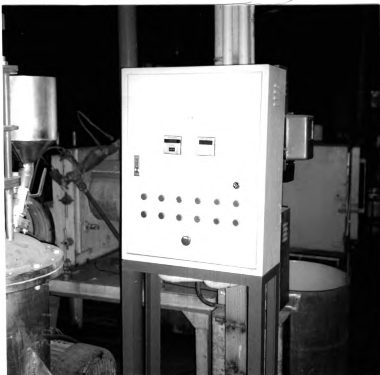
รูปที่ 3.6 ชุดควบคุมการทำงานของมอเตอร์และวาล์วของท่อไอน้ำ
