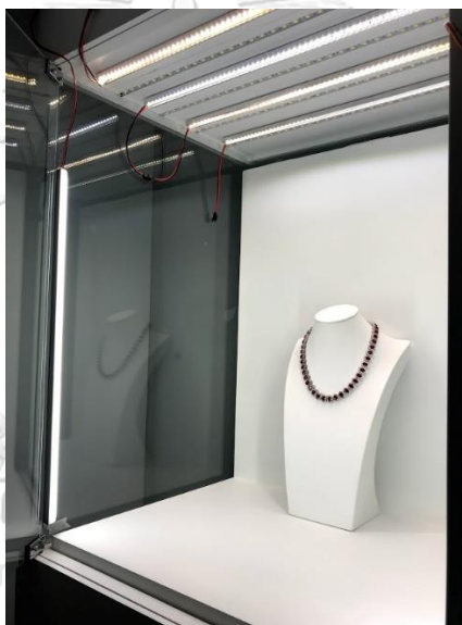
ภาพที่ 3.8 การติดตั้ง LED strip light ภายในตู้โชว์ ด้านบนและด้านหน้า
