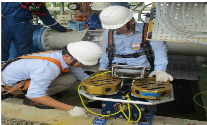
รูปที่ 5.15 การตรวจสอบการอุดตันของที่กรองเครื่องสูบโดยใช้หุ่นยนต์ถ่ายภาพ
