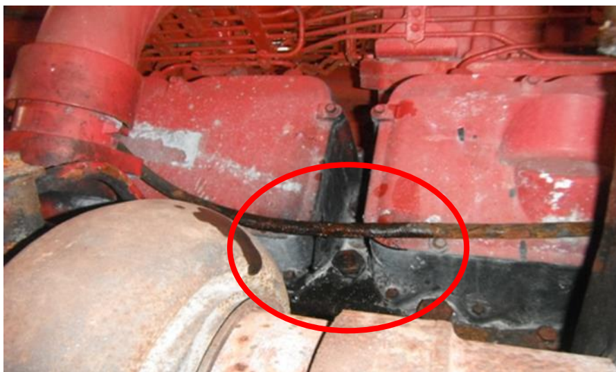
รูปที่ 3.4 สายน้ำมันเชื้อเพลิงของเครื่องสูบน้ำดับเพลิงรั่วบริเวณเทอร์โบของเครื่องสูบน้ำดับเพลิง
