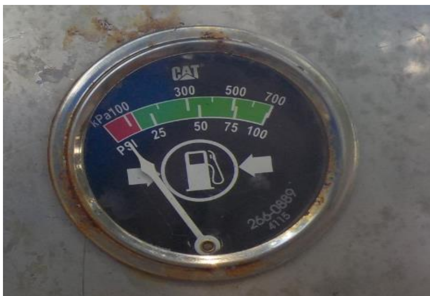
รูปที่ 6.6 ผลการตรวจสอบพบความผิดปกติจากระดับความดันน้ำมันเชื้อเพลิงต่ำ
