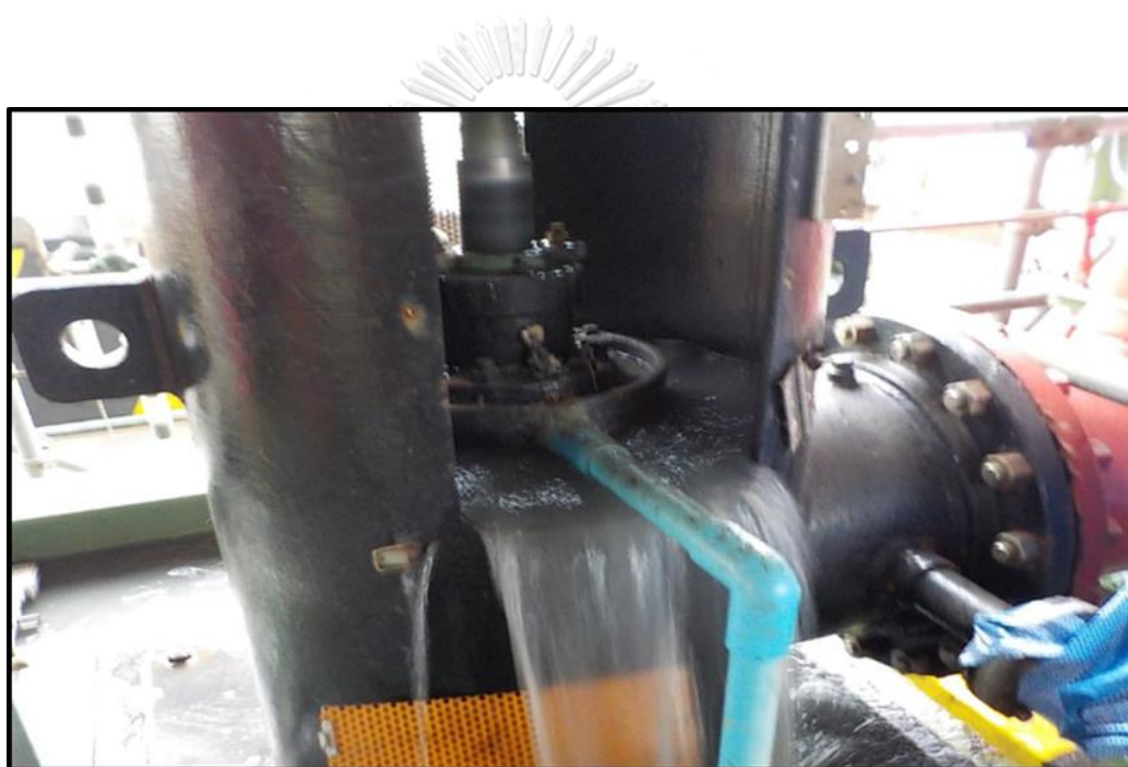
รูปที่ 1.5 ความเสียหายเครื่องสูบน้ำดับเพลิงที่เกิดจากปัญหาผุกร่อนเครื่องสูบน้ำดับเพลิงทะเล
