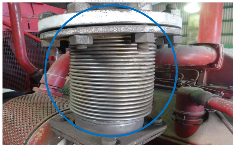
รูปที่ 5.6 จุดตรวจสอบรอยแตกร้าวของท่อไอเสีย
