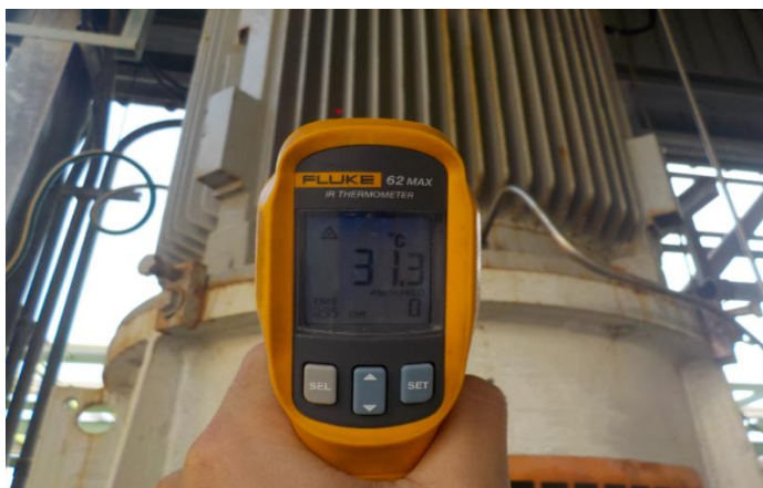
รูปที่ 5.2 แสดงการตรวจวัดอุณหภูมิด้าน DE และ NDE ของมอเตอร์ไฟฟ้า
