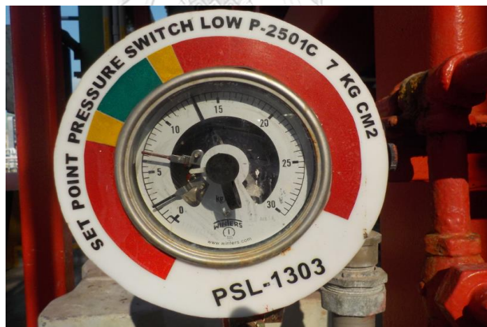
รูปที่ 5.10 เกจสำหรับตรวจสอบการตั้งค่าของสวิตช์ควบคุมความดัน
