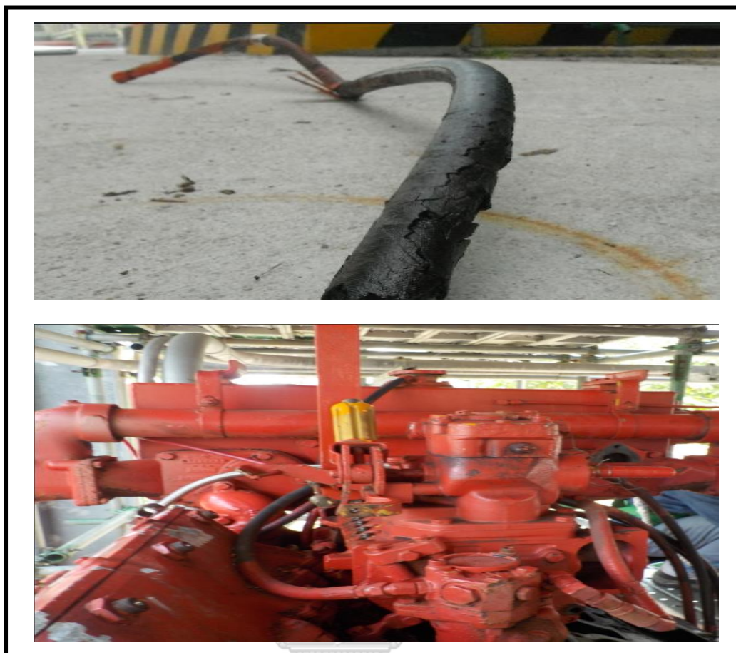
รูปที่ 6.7 ผลการตรวจสอบพบความผิดปกติจากสภาพสายน้ำมันเชื้อเพลิงเสื่อมสภาพ
