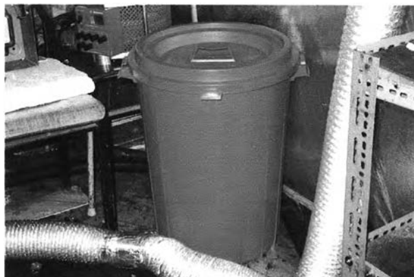
รูปที่ 4.6 ถังน้ำ
