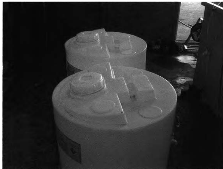
รูปที่ 3.6 ถังรับน้ำทิ้งจากระบบ
