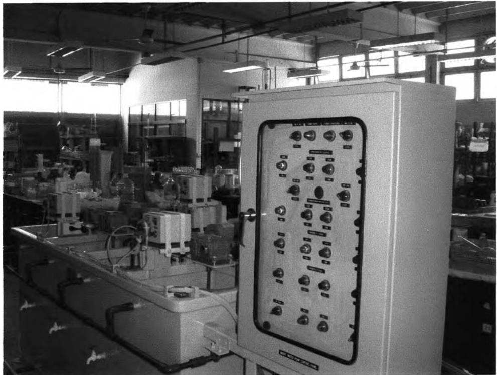
รูปที่ 3.11 ตู้ควบคุมระบบ
