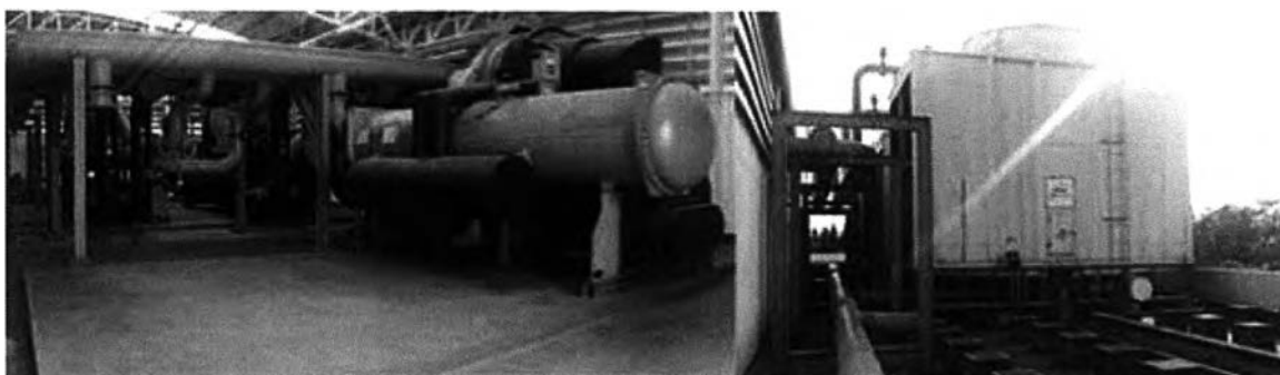
รูปที่ 4.9 ระบบปรับอากาศ
