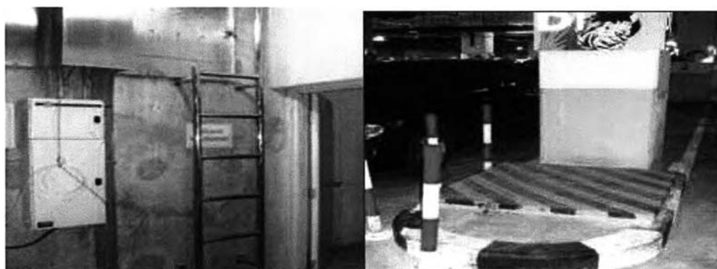
รูปที่ 4.10 ถังพักน้ำดาดฟ้า และ ใต้ดิน
