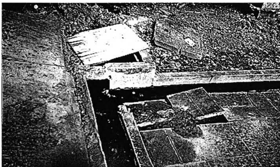
รูปที่ 5-19 ฝาท่อระบายน้ำ บริเวณอาคารชำรุด
