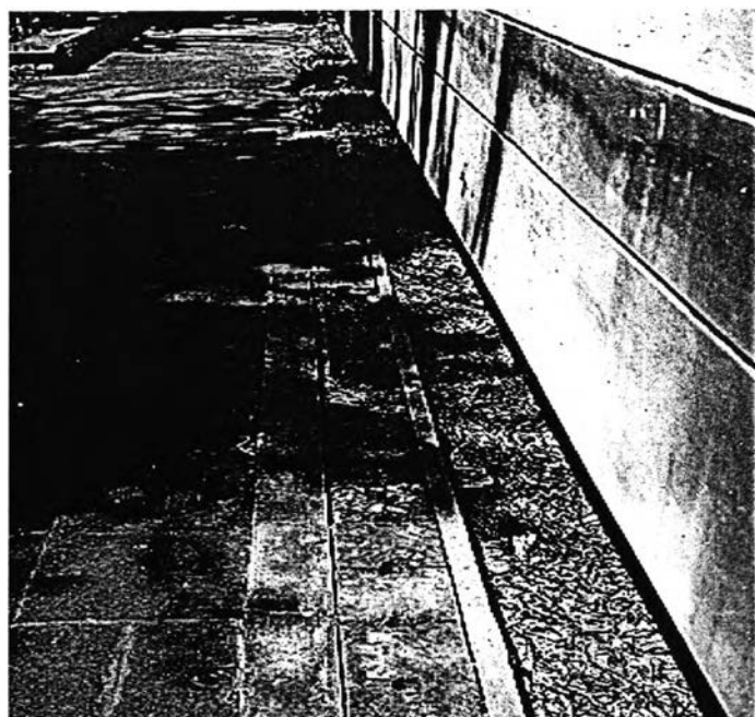
รูปที่ 5-18 ฝาท่อระบายน้ำบริเวณอาคารชำรุด
