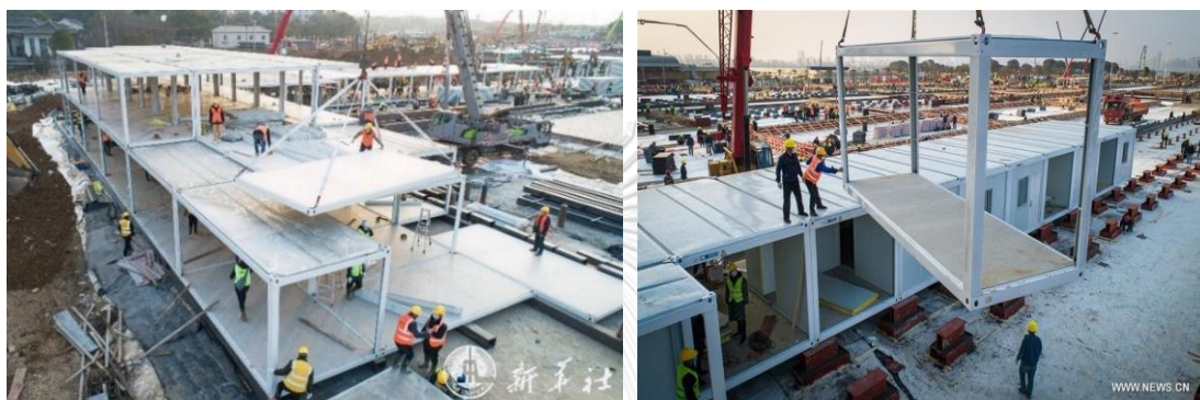
รูปที่ 19 ขั้นตอนการประกอบอาคารโดยใช้คอนกรีตในการยกประกอบ
