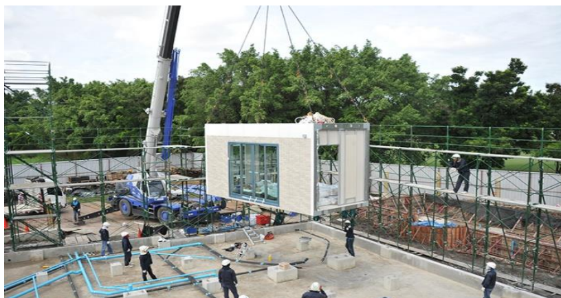
รูปที่ 15 ขั้นตอนการประกอบบ้าน SCG HEIM ภายในพื้นที่ก่อสร้าง ที่มา https://www.scgheim.com/concept/
