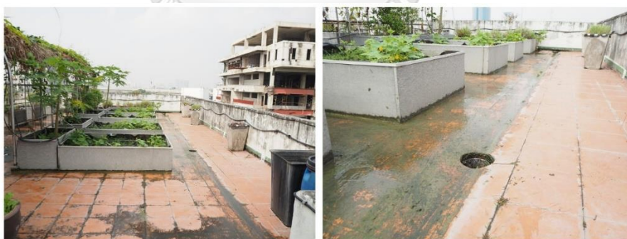
ภาพ 68 แสดงท่อระบายน้ำออกจากพื้นโครงการ คณะสถาปัตยกรรมศาสตร์ ม.เกษตรฯ
