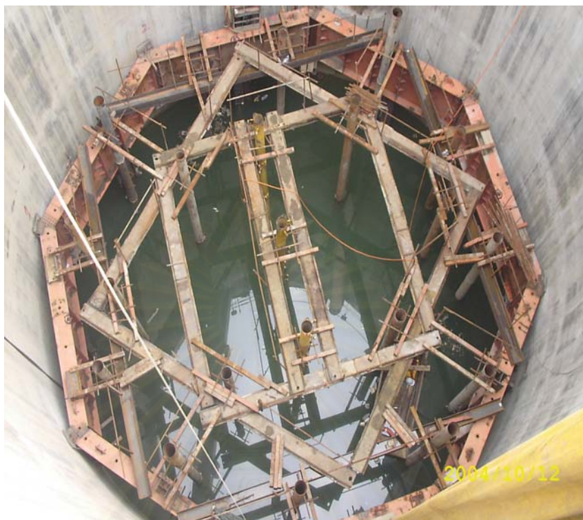
รูปที่ 3.22 การจัดตำแหน่ง Trimie pipe เพื่อเท Concrete plug
