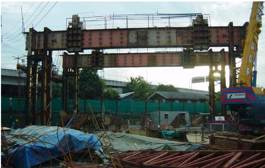
รูปที่ 3.8 โครงสร้าง Jacking beam
