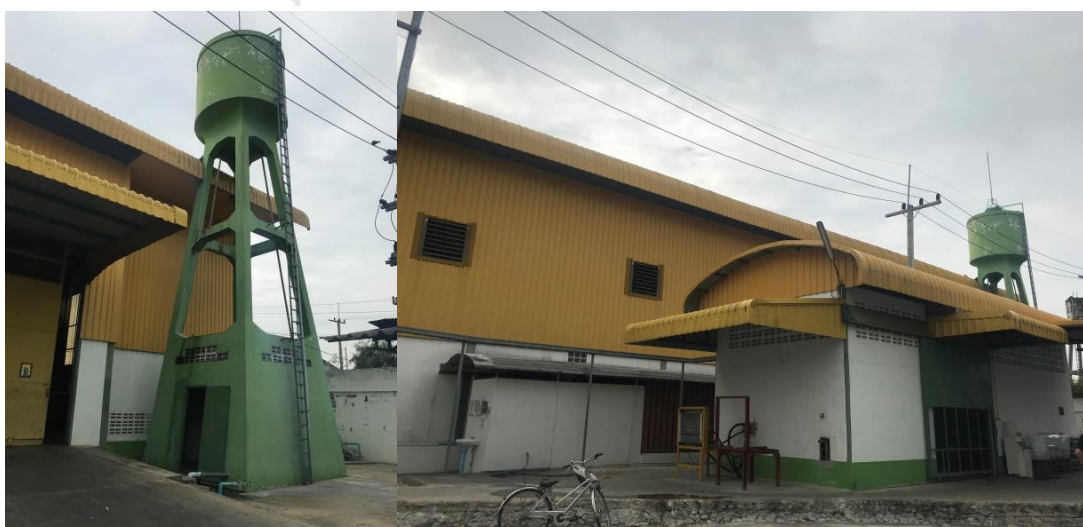
รูปที่ 4.17 สถานีสูบน้ำและบำบัดน้ำบาดาลของโรงงานผลิตพลาสติกแห่งหนึ่งในจังหวัดนครปฐม
