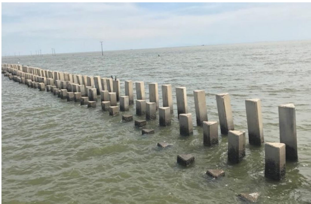
รูปที่ 2-13 เขื่อนกันคลื่นแบบเสาเข็มที่ชายฝั่งบ้านขุนสมุทรจีน
