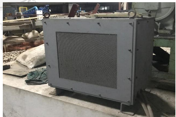
ฉ) หม้อแปลงควบคุม
