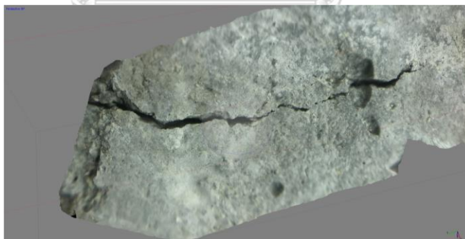
ภาพที่ 33 แบบจำลองลักษณะพื้นผิวรอยร้าวคอนกรีต (มุมมองด้านบน)
