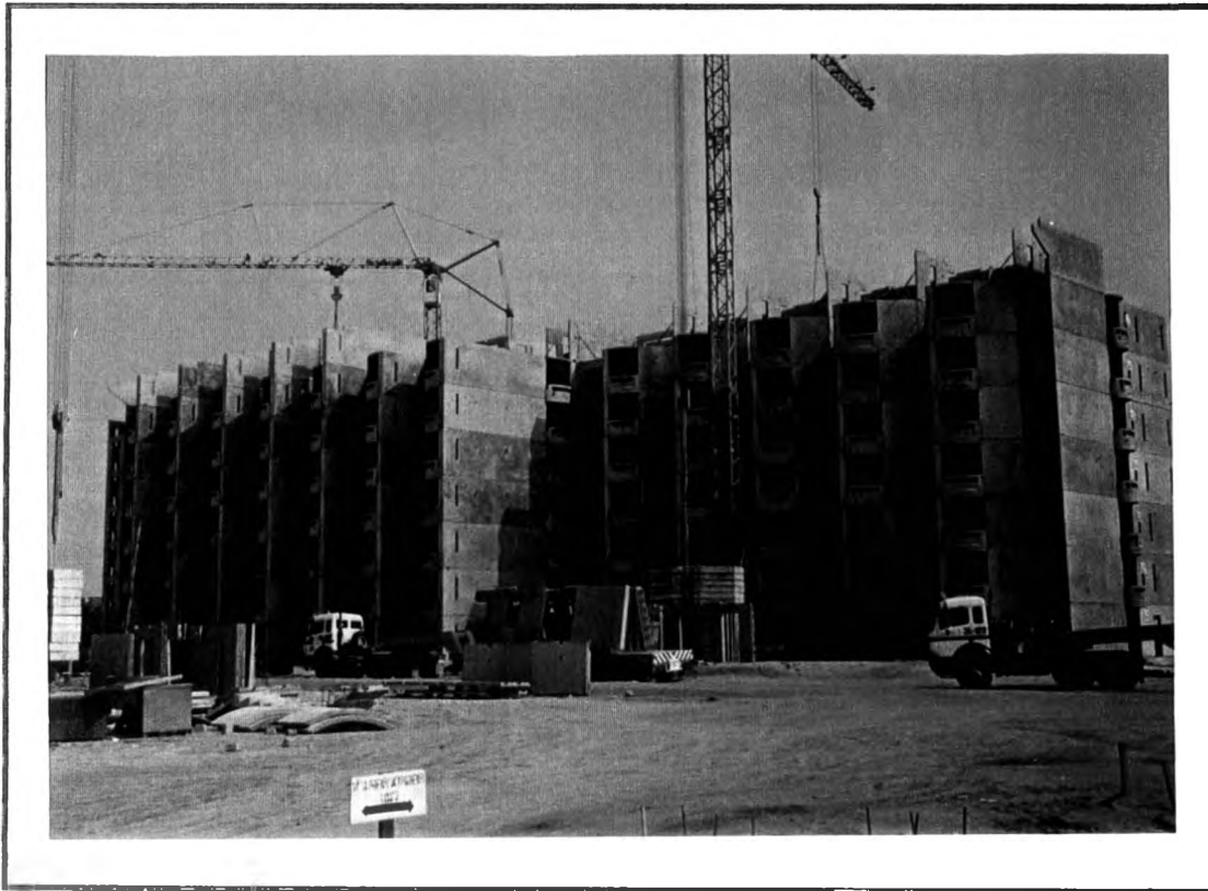
รูปที่ ง.6 อาคารโครงการ ง ที่ก่อสร้างด้วยระบบสำเร็จรูป
