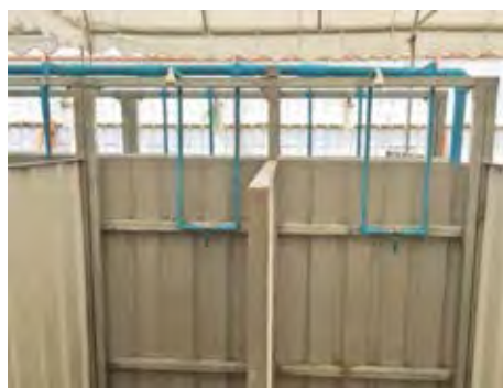
ภาพที่ 37 ห้องอาบน้ำระบบฝักบัว
