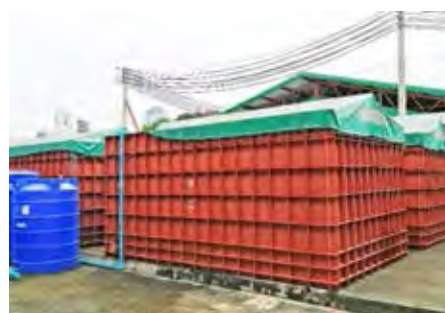
ภาพที่ 28 บ่อบำบัดน้ำเสีย
