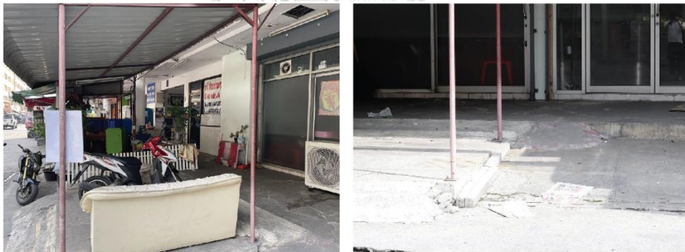
ภาพที่ 5.30 สภาพพื้นทางเดินและรอยแตก้าวอพาร์ทเมนต์ งามิ แมนชั่น
