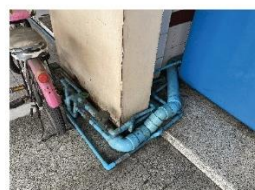
การต่อเติมระบบน้ำภายนอกอาคาร ถาวรแมนชั่น (3.33)
