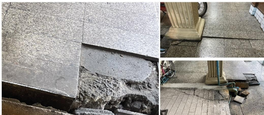
ภาพที่ 5.37 สภาพรอยแตกร้าวและหลุมร่อนของกระเบื้องทางเดิน อพาร์ทเมนต์ ถาวร แมนชั่น
