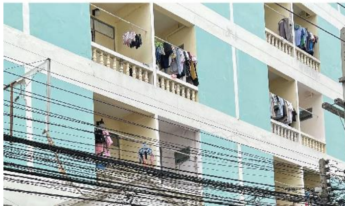
ภาพที่ 5.36 สภาพรอยแตกร้าวเปลือกอาคาร ถาวร แมนชั่น
