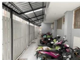
การต่อเติมหลังคาด้านหลัง ชัยมงคลเฟลต (4.00)
