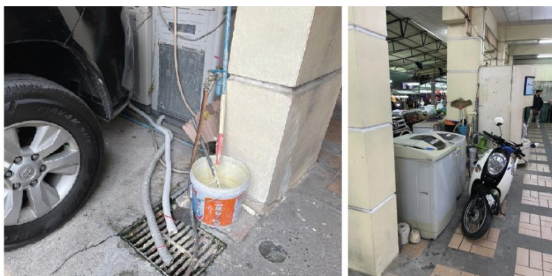
ภาพที่ 5.26 การติดตั้งตู้กดน้ำและเครื่องซักผ้าบังทางเดิน อพาร์ทเมนต์ แกรนด์ แมนชั่น
