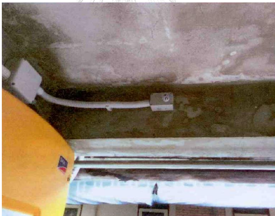
รูปที่ 3-3 การติดตั้งอุปกรณ์วัดค่าอุณหภูมิสภาพแวดล้อม
