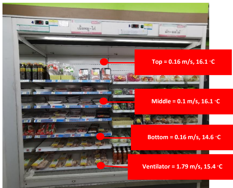
รูปที่ ค.5 ตำแหน่งการวัดค่าความเร็วลมและอุณหภูมิของตู้เย็นแบบประตูเปิด สำหรับแช่เนื้อและผัก (จุดที่ 4 และจุดที่ 5)
