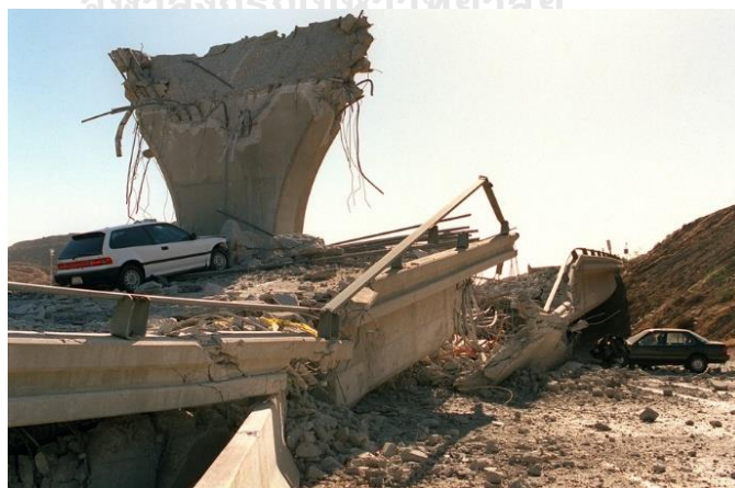
รูปที่ 1.1 การวิบัติของช่วงสะพาน (Span collapse) จากแผ่นดินไหว Northridge (1994) (Taylor, 2014)
