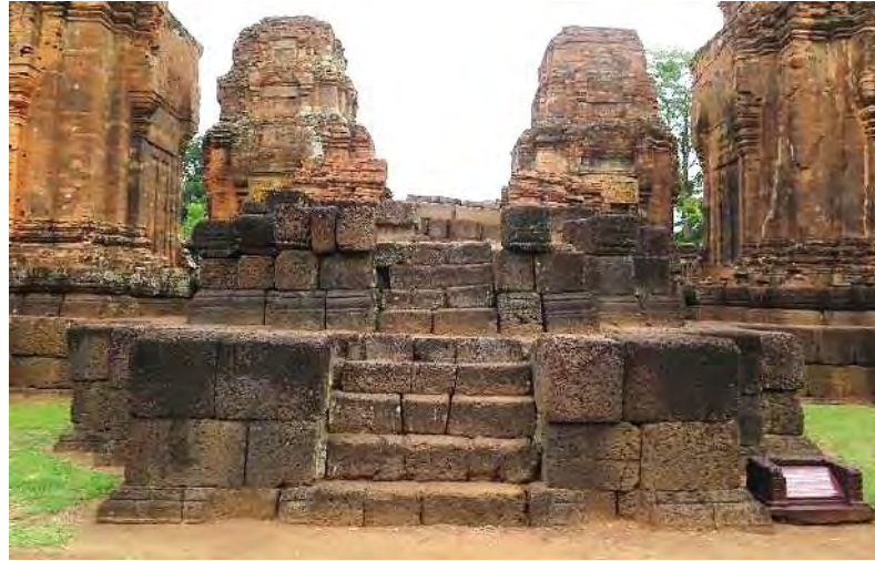
รูปภาพที่ 193 บริเวณส่วนฐานรองรับน้ำหนักปราสาทประธานและปราสาทบริวาร
