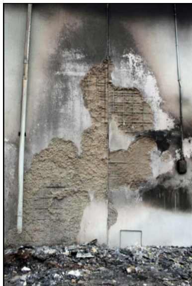
รูปที่ 7 ลักษณะการหลุดล่อนของคอนกรีตในสภาวะเพลิงไหม้ (Jansson, 2013)
