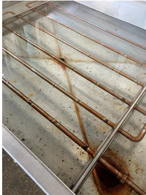
รูปที่ 4.10 อ่างล้างตัวกรองลม
