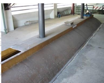
บ่อสัมผัส และบ่อย่อยสลาย
