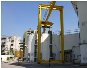
สถานีสูบน้ำเสียเข้าระบบ
