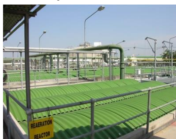
ถังเติมอากาศ
