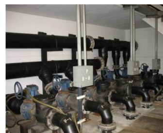
บ่อรวบรวมน้ำเสีย และเครื่อง สูบน้ำเสีย
