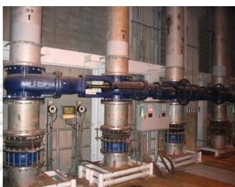
สถานีสูบน้ำเข้าระบบแบบ CASS
