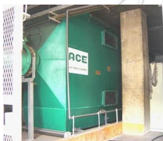
Scrubber กำจัดกลิ่น
