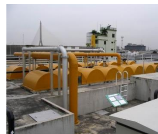
ถังเติมอากาศชั้นแรก
