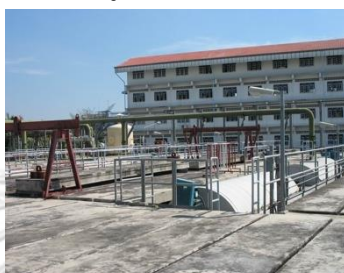
ถังเติมอากาศ
