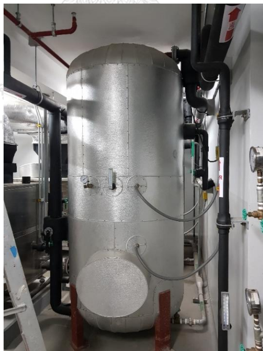
รูปที่ 3 ถังเก็บน้ำร้อนของฮีทปั๊มขนาดถึง 2000 ลิตร
