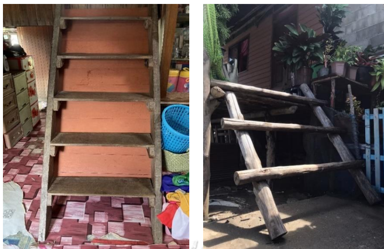
ภาพที่ 29 บ้านไคที่พบใน กลุ่มเรือนหลังคาทรงแปริก (กลุ่มเรือนที่มีช่วงอายุที่80 -100 ปี ) ที่มา : ผู้วิจัย, 2565
