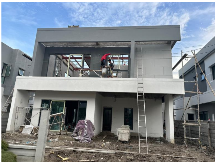
รูปที่ 5.12 รูปภาพแสดงโครงการกรณีศึกษาที่ 2 ซึ่งเป็นการก่อสร้างที่พักอาศัย ประเภทบ้านเดี่ยว
