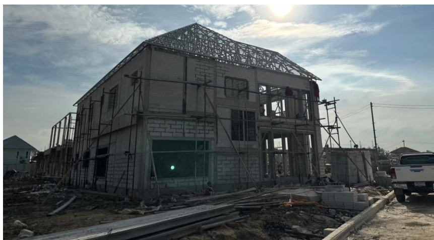
รูปที่ 5.38 รูปภาพแสดงโครงการกรณีศึกษาที่ 4 ซึ่งเป็นการก่อสร้างที่พักอาศัยประเภทบ้านเดี่ยว
