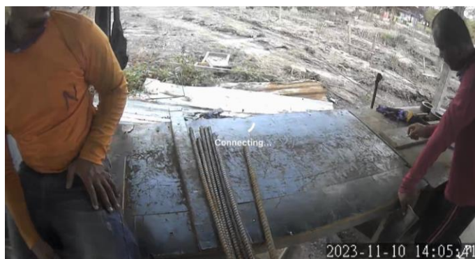
รูปที่ 5.5 รูปภาพแสดงกิจกรรมกิจกรรมหลักตัดและตัดเหล็ก (โครงการกรณีศึกษาที่ 1)
