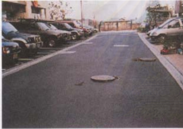
1.3 สภาพพื้นถนนเหนือสระ
