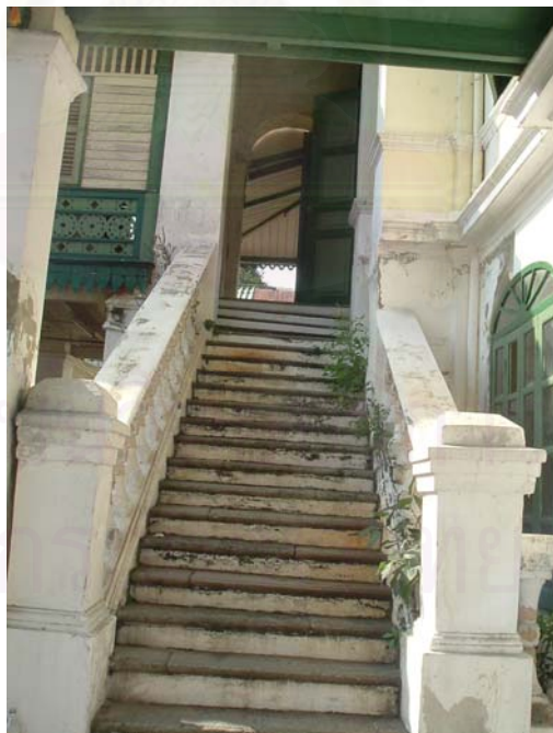
ภาพบันไดทางขึ้นพระตำหนัก บันไดทางขึ้นปูด้วยซีเมนต์บางส่วนสภาพชำรุด ที่มา : ผู้วิจัยถ่ายเมื่อ 15 กุมภาพันธ์ 2550
