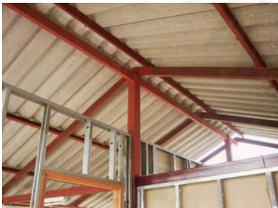
รูปที่ 5.3.16 แสดงโครงหลังคาเหล็ก
