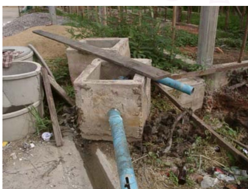
รูปที่ 4.56 แสดงบ่อพักและท่อน้ำเสียที่ชาวบ้านขุดขึ้นมา เนื่องจากต้องการตั้งเสาบริเวณนั้น
