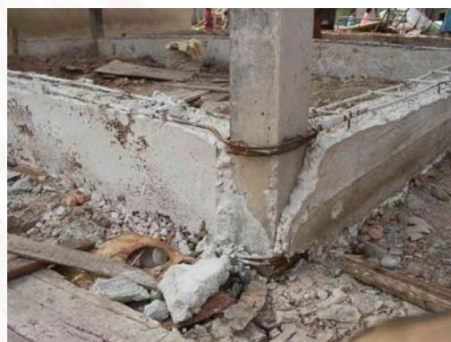
รูปที่ 4.55 แสดงการต่อเหล็กเสริมคานกับเสา โดยรอบเสา ทำให้การถ่ายน้ำหนักทำไม่ได้
