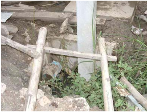
รูปที่ 4.58 แสดงบ่อพักน้ำเสียที่เสียหายเนื่องจาก การก่อสร้างบริเวณนั้น
