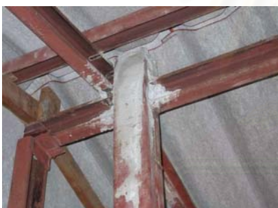
รูปที่ 5.5.8 แสดงการกรอกปูนในเสาเหล็กทุกต้นเพื่อเพิ่มความแข็งแรง
