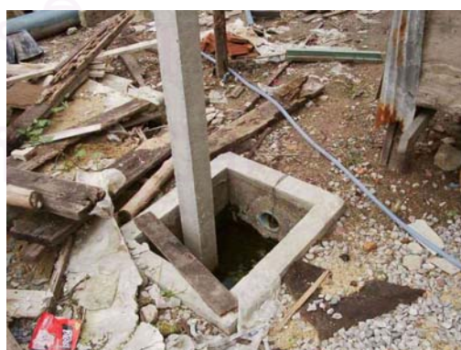
รูปที่ 4.57 แสดงบ่อพักน้ำเสียที่ชาวบ้านตั้งเสาไปในบ่อพักเลย เนื่องจากต้องการพื้นที่มากขึ้น
