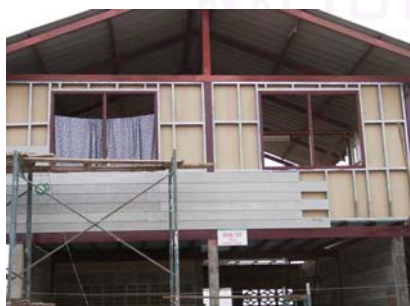
รูปที่ 5.3.13 แสดงการติดตั้งกระเบื้องแผ่นเรียบผนังภายนอก
