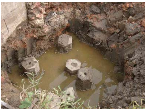
รูปที่ 4.52 แสดงสภาพดินที่แข็งมาก ไม่สามารถตอกเสาเข็มได้ในตำแหน่งที่ต้องการ
