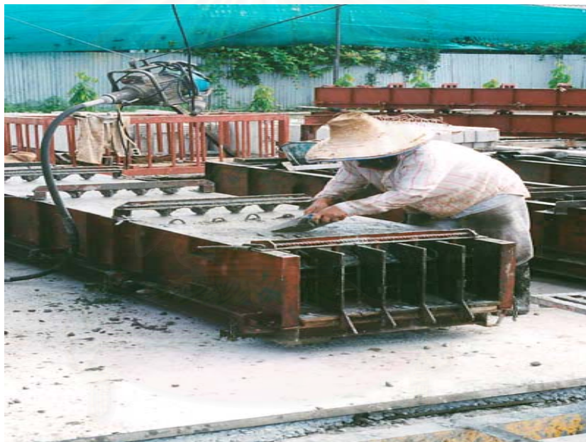
ภาพที่ 5.10 แสดงขั้นตอนการเทคอนกรีตลงในแบบคานสำเร็จรูป
