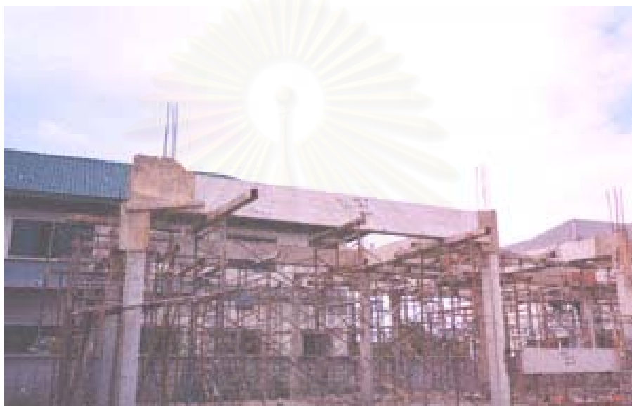
ภาพที่ 5.22 แสดงการประกอบติดตั้งเสา-คานสำเร็จรูป ประสานโครงสร้าง
