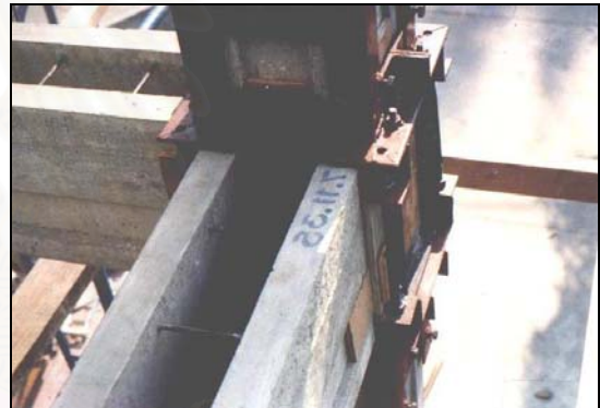
ภาพที่ 4.80 แสดงรายละเอียดเครื่องช่วย – แบบหล่อบริเวณเสา – คาน ก่อนการเทคอนกรีต
