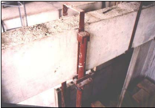
ภาพที่ 4.91 แสดงรายละเอียดเครื่องช่วยและค้ำยันส่วนบนตรงบริเวณกลางคาน
