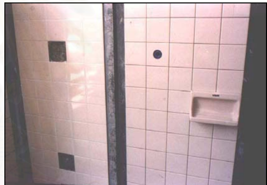
ภาพที่ 4.46 แสดงข้อต่อและจุดติดตั้งสุขภัณฑ์ สามารถเตรียมไว้ได้ในขั้นตอนการผลิตแผ่นผนัง
