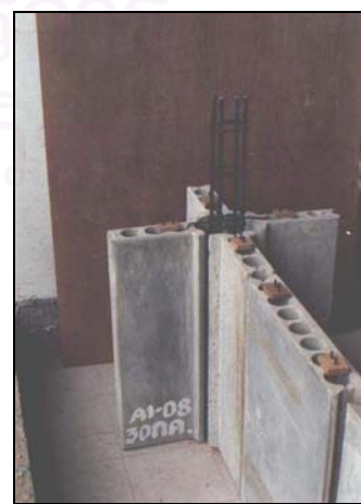
ภาพที่ 4.12 แสดงการติดตั้งแผ่นเสา 4 แผ่น
