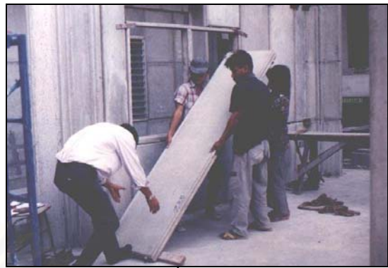
ภาพที่ 4.20 แสดงการติดตั้งแผ่นผนัง ขนาด 0.60 x 2.40 ม.
