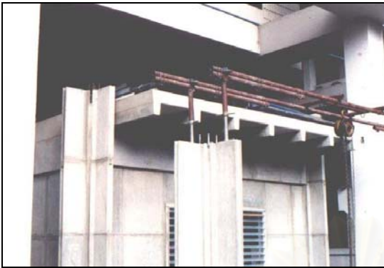
ภาพที่ 4.25 แสดงเครื่องช่วยยกแผ่นผนัง ติดตั้งบนเสาที่หล่อเสร็จแล้ว
