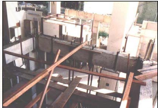
ภาพที่ 4.88 แสดงคานสำเร็จที่สร้างจากแบบหล่อเฟอร์โรซีเมนต์ พร้อมทั้งจะถอดเครื่องช่วย - ค้ำยัน
