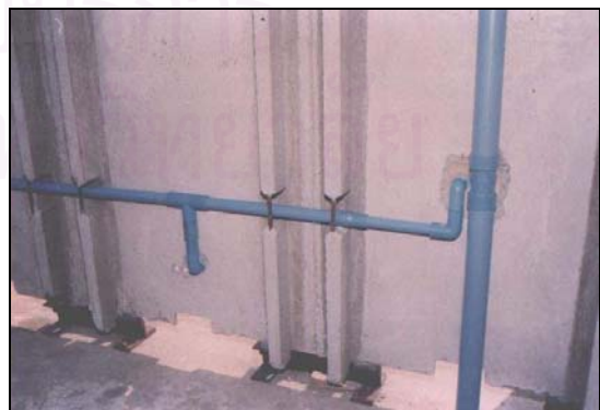
ภาพที่ 4.42 แสดงท่อประปา - ระบายน้ำ ผ่านช่องเดินท่อที่เตรียมไว้ บริเวณผนังด้านนอก
