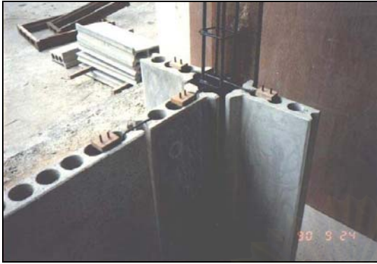
ภาพที่ 4.13 แสดงพุกรองรอยต่อแผ่นผนังและแผ่นเสา
