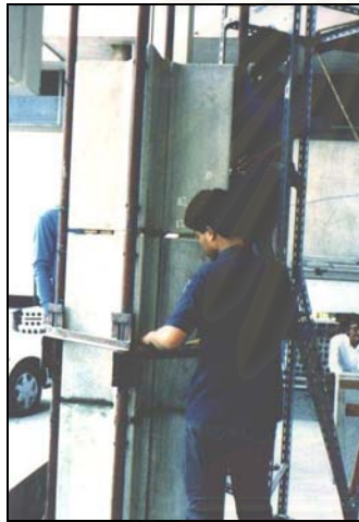
ภาพที่ 4.15 แสดงการติดตั้งแผ่นเสาโดยใช้อุปกรณ์เหล็กยึดแผ่นเสาช่วยในการติดตั้ง
