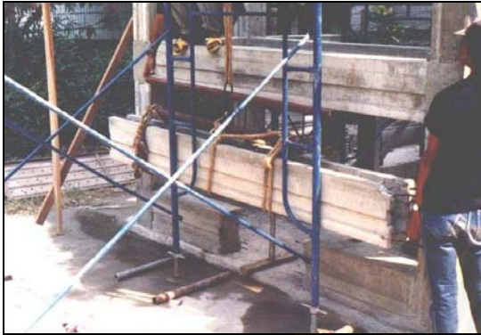
ภาพที่ 4.77 แสดงการยกคานขึ้นติดตั้งบนหัวเสาชั้นเดียว
