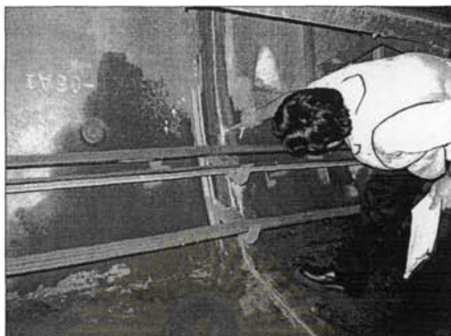
รูปที่ 4.15 การรั่วไหลของน้ำบริเวณรอยต่อระหว่างชิ้นส่วนคอนกรีต
