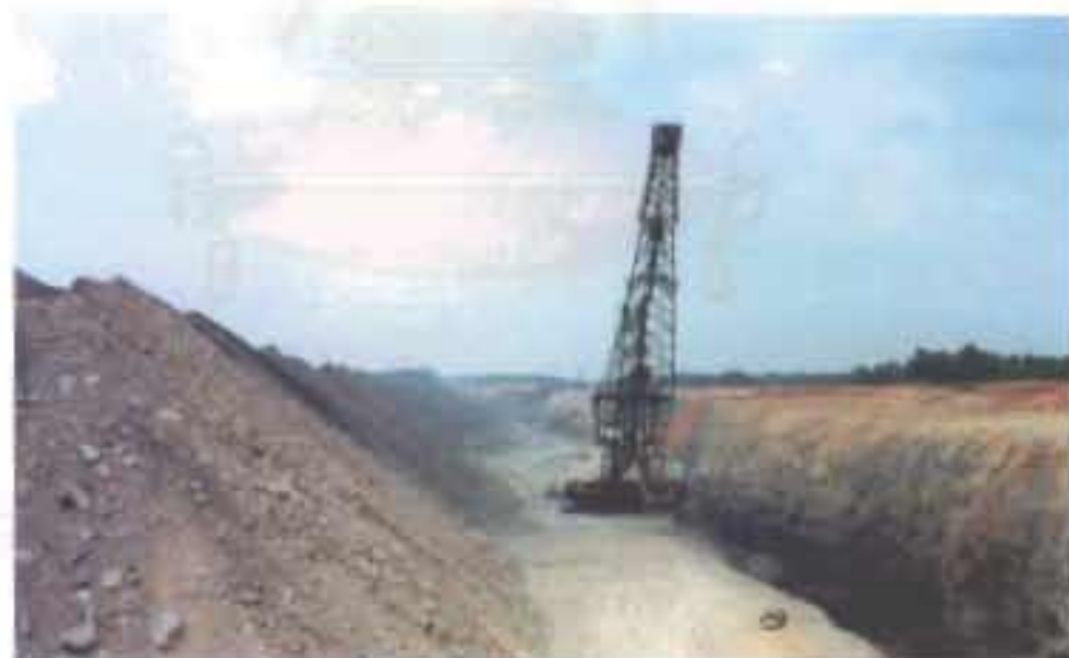
รูปที่ 4.15 ลักษณะงานการตัดร่องแนวยาว (trench) ของวัสดุหน้างาน ก่อนข้างค้ำ และพื้นที่ระดับฐานก่อนข้างแน่น เหมาะสำหรับ เลือกใช้รถตักเสยแบบมีล้อตีนตะขาก นิยมใช้ในเหมืองถ่านหิน
