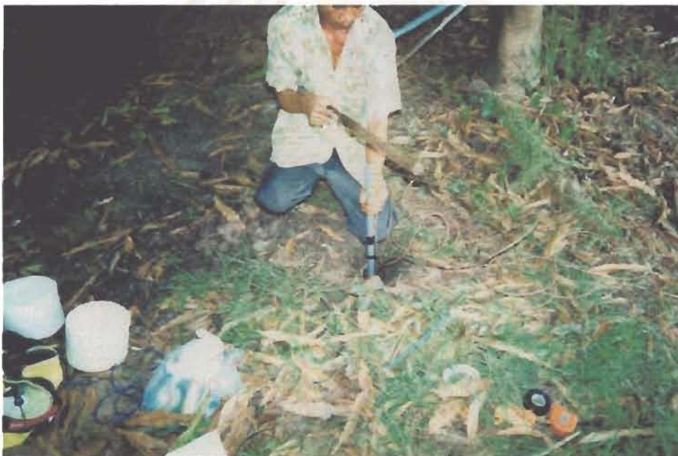
รูปที่ 1-11 แสดงการติดตั้งสาย THERMOCOUPLE ลงไปในพื้นดิน
